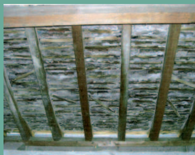
VUE INTÉRIEURE DE LA COUVERTURE, CERTAINS LITEAUX SONT CASSÉS, ATTEINTS PAR LA POURRITURE DU BOIS
