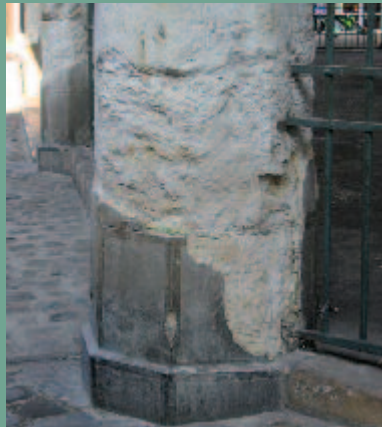
ÉROSION DES PILIERS EN PIERRE (AVANT RESTAURATION)
